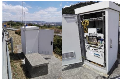
Figura 6. Exemplo de instalação num armário de beira da estrada
