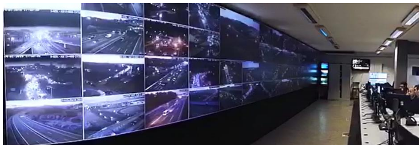
Fig. 5 – Centro de Controlo de Trafego da IP
