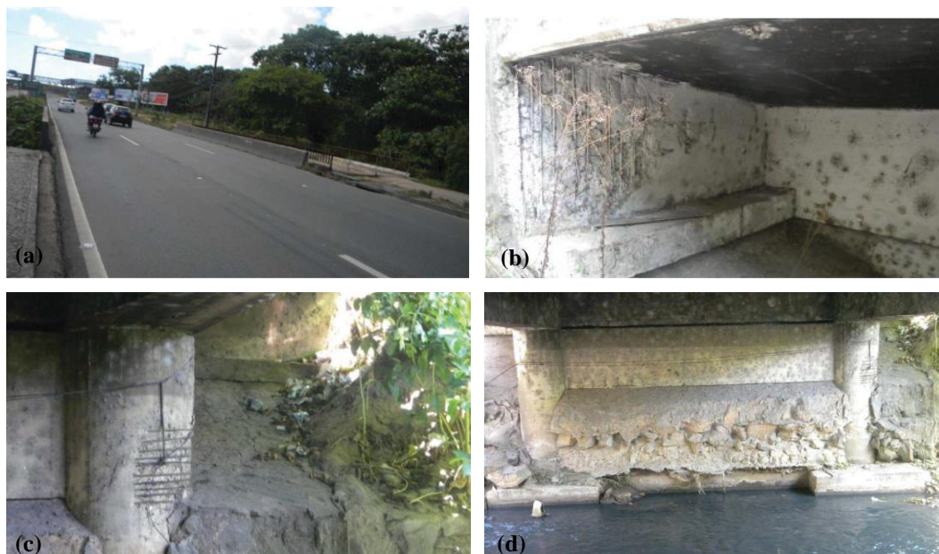
Fig.3. (a) Vista superior da Ponte sobre o Rio Barro Branco; (b) Exposição e oxidação de armaduras com desprendimentos de concreto na face lateral da extremidade da cortina; (c) exposição de armaduras transversais com deslocamentos de concreto, agravado pela deficiência de cobertura na face do pilar e (d) erosão de pedras no revestimento do talude, cuja evolução poderá carrear o material de aterro na ligação com o pavimento e causar danos na cabeceira da obra.
