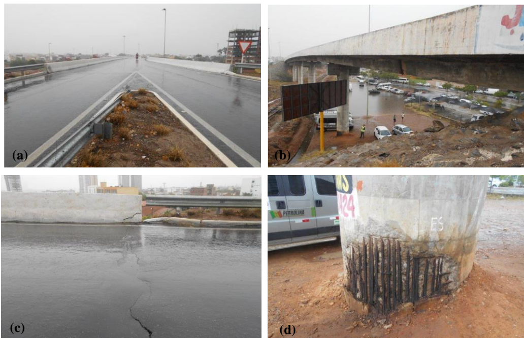
Fig.1. (a) Vista superior do Viaduto dos Barraqueiros; (b) vista lateral, os trechos em rampa e o detalhe do pilar e da laje do trecho central; (c) junta de encontro recoberta por capa asfáltica com sinal de ruptura e (d) concreto desagregado com armadura exposta e estribos rompidos.
