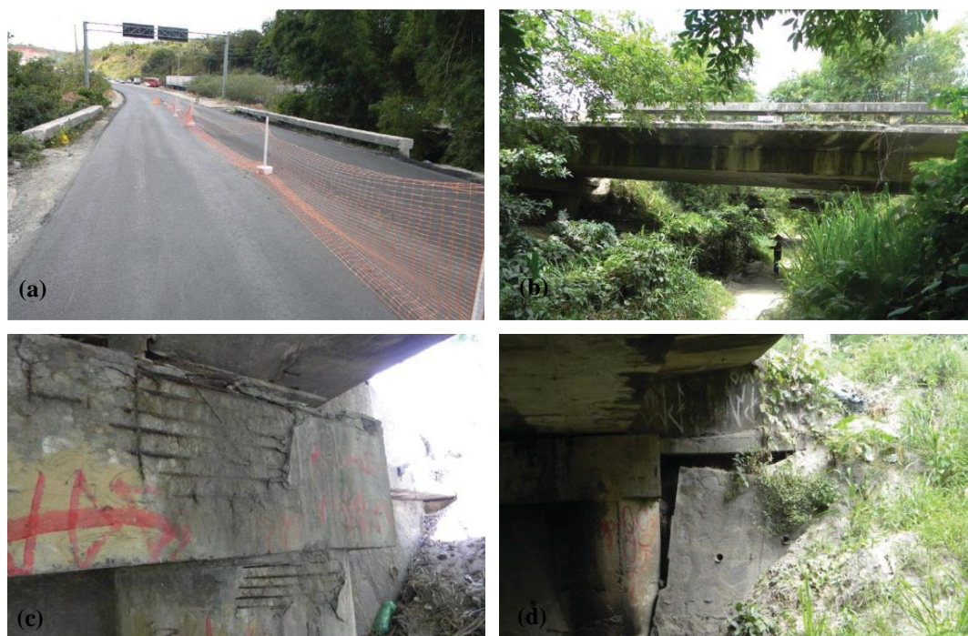
Fig.4. (a) Vista superior da Ponte BR-101/PE (LE) – km 58,620; (b) vista lateral; (c) exposição de armaduras devido ao processo corrosivo, com perdas de seção na face frontal da travessa e do pilar com deslocamentos do cobrimento e (d) deslocamento de parte do muro de contenção em alvenaria de pedras argamassadas sob a cortina.
