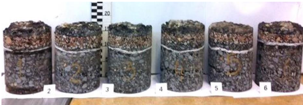
Fig.2. Aspeto geral dos tarolos colhidos do trecho da Variante de Beja, com aplicação de grelha de fibra de vidro [6]
