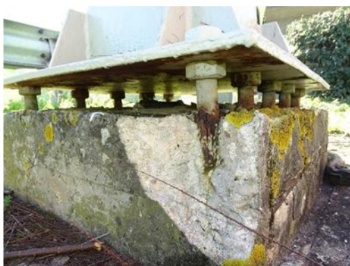
Figura 8. Espaço vazio existente na ligação entre o montante e o plinto da fundação.
