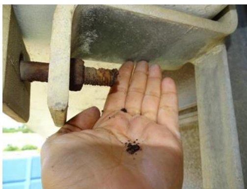
Figura 5. Corrosão do sistema de fixação.
