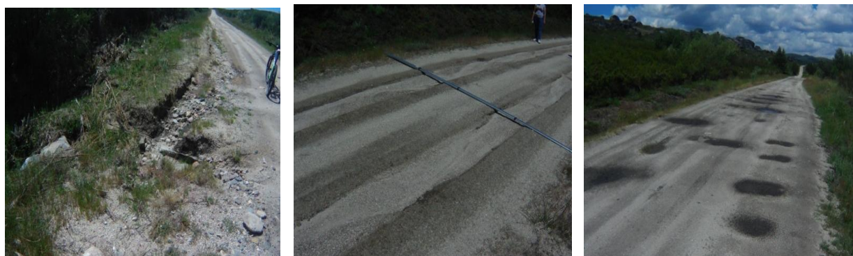
(a) Vala inexistente.
