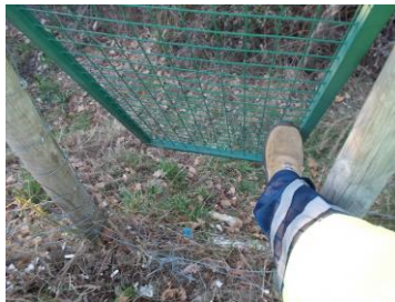
Fig. 2. Portão basculante existente na A24
