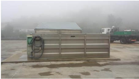
Fig. 9. Estação de Salmoura
