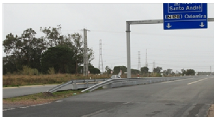
Fig.2. Barreira de segurança desconforme e má protecção do tráfego vs. obstáculo perigoso
