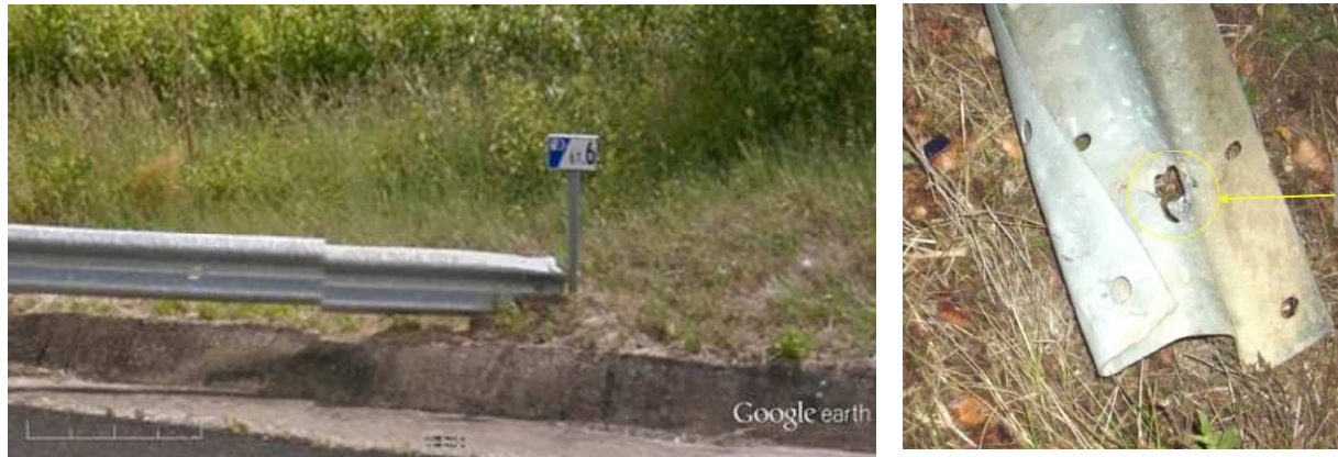
Fig.3. Exemplo de deficiente enterramento da extremidade de terminal (Fontes: Google earth e GNR)
