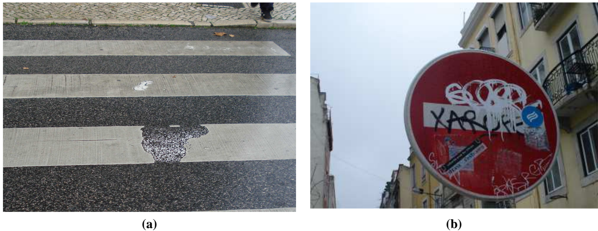
Fig.1. Exemplos comuns de deterioração de sinalização: (a) sinalização horizontal com deterioração progressiva devido às ações climáticas e ao uso contínuo de uma passagem para peões e (b) vandalização de sinalização vertical.
