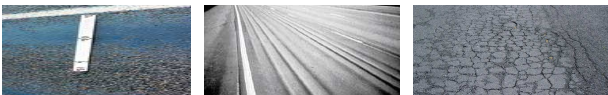
Fig. 1. Anomalias em pavimentos rodoviários: exsudação [1], formação de cavalos de rodeira e fendilhamento [2]
