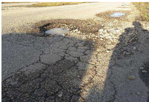
Fig. 2. Estado duma estrada após precipitação intensa
