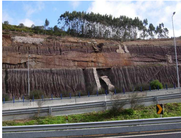
Fig. 3. Ravinamentos superficiais e profundos ao longo de todos os panos do talude; colapso de algumas obras de reparação realizadas.
