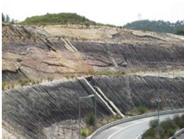
Fig.1. Perspetiva geral do talude de escavação do nó da Malveira (sentido A8-Malveira)
