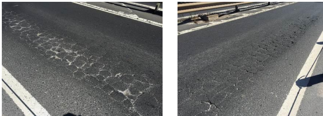
Fig.4. Degradações do Pavimento
