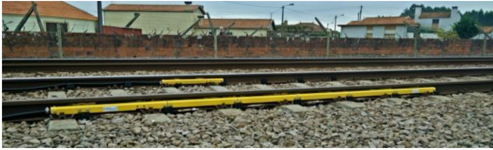
Fig. 3. Sistema de monitorização por análise de vibração instalado na infraestrutura [2]
