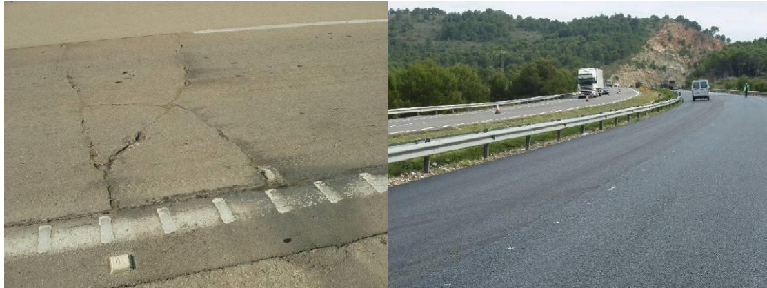
Fig.1. Pavimento fissurado antes e depois do tratamento com betumes modificados de elevado desempenho
