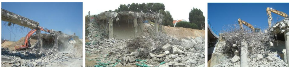
Fig.5. Demolição das restantes secções do tabuleiro e dos pilares de uma PS
