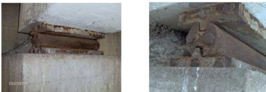
Fig. 3. Aparelhos de apoio nos encontros e nas juntas intermédias do tabuleiro com corrosão
