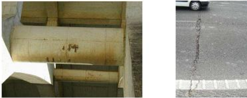
Fig. 4. Corrosão de armaduras nos contraventamentos e fendilhação do pavimento betuminoso
