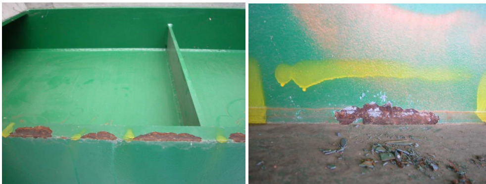
Fig.13. danos causados em obra (esq.) e defeitos de aplicação de esquema de pintura (dir.)
