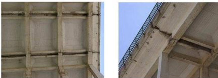
Fig. 2. Escorrências de água nas juntas estruturais do tabuleiro e delaminações locais nas consolas
