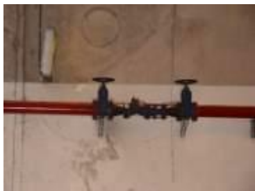
Avaria de válvulas volantes
