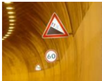
Sinalização vertical deteriorada
