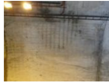
Recobrimento insuficiente das armaduras
