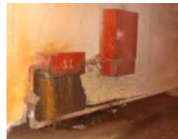
Fugas na rede de incêndio/ reservatórios
