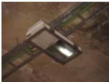
Armaduras de iluminação danificadas
