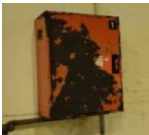
Deterioração de equipamentos
