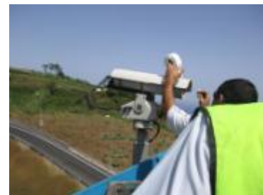
Acumulação de sujidade em detetores/câmaras de CFTV
