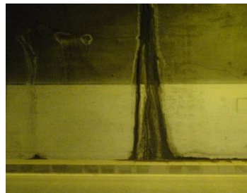
Infiltração de água por juntas construtivas
