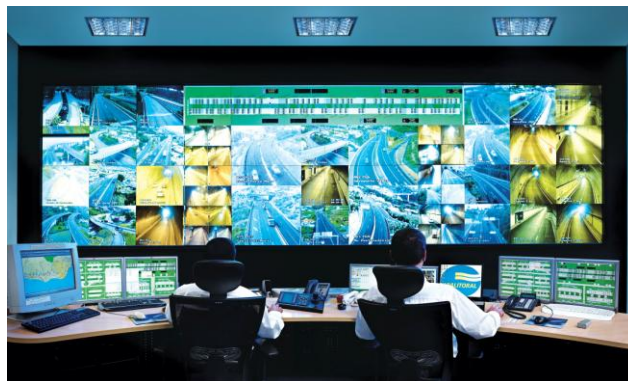
Fig.2. Centro de Controlo da VIALITORAL
