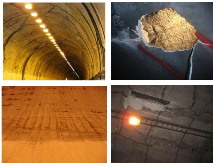
Fig.4. Anomalias no revestimento dos Túneis
