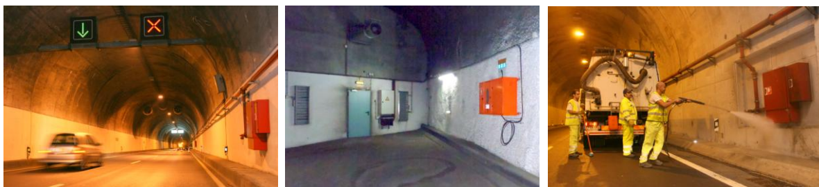
Fig.3. Alguns Equipamentos dos Túneis
