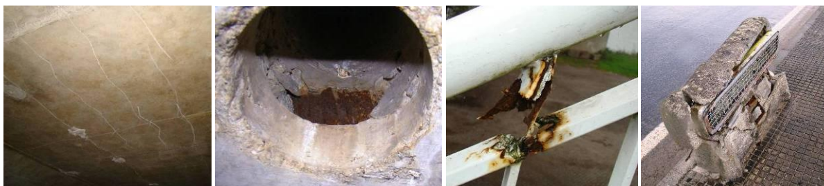
Fig. 3 Anomalias no tabuleiro (antes da intervenção).
