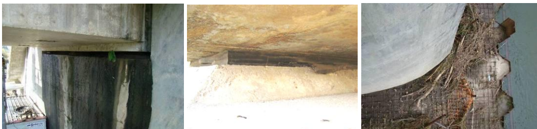
Fig. 2 Anomalias em encontros, aparelhos de apoio e ensecadeiras (antes da intervenção).
