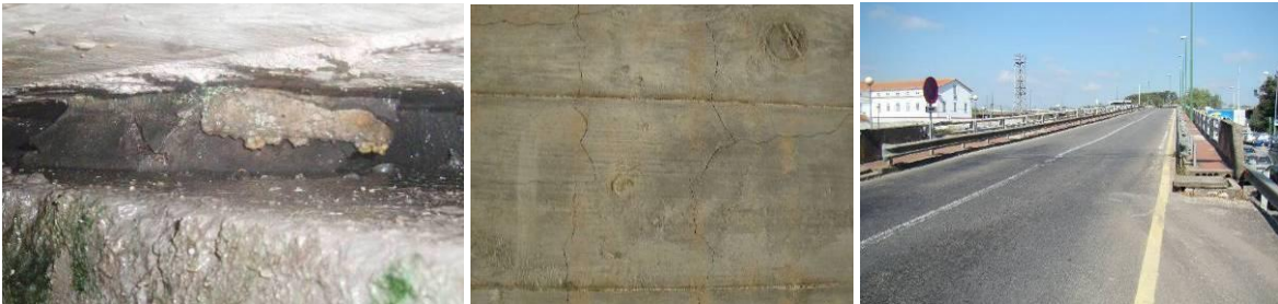
Fig.8. Pormenor de um aparelho de apoio nos encontros com distorção excessiva; Pormenor de fendilhação em malha na face inferior do tabuleiro; Pormenor da deformação excessiva do tabuleiro.
