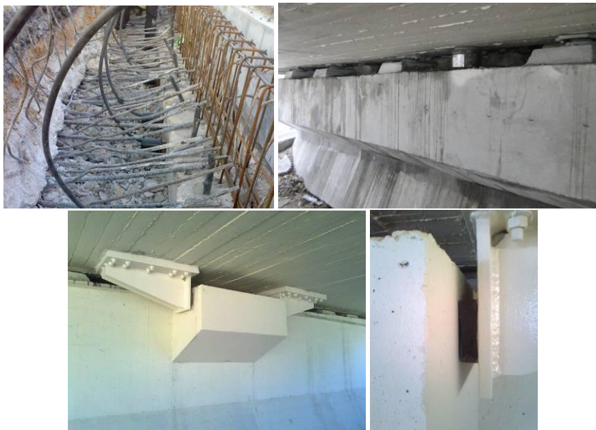
Fig.14. Pormenor no tardo do encontro E1 com selagem de armaduras do novo espelho; Vista final frontal do encontro E1; Pormenor dos batentes nos encontros Ea/ Eb/ Ef; Pormenor do bloco de neoprene.
