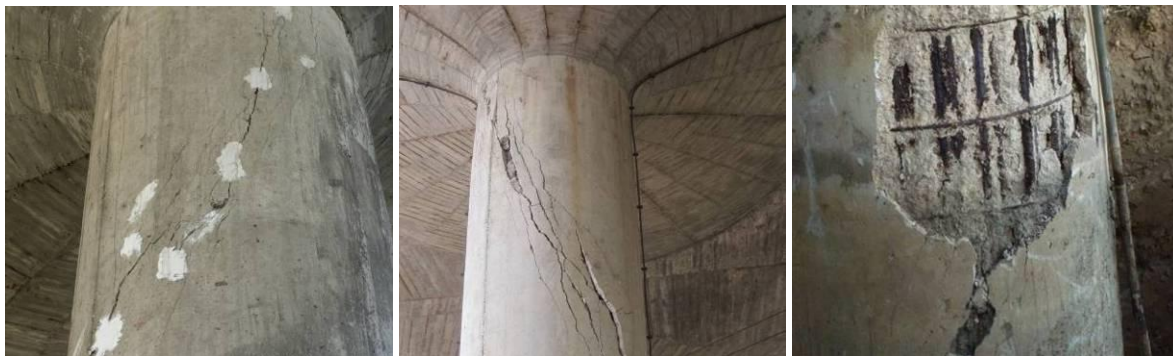
Fig.9. Pilares com fendas diagonais com aberturas superiores a 2mm e rejeito dos bordos das fendas; destaque do betão de recobrimento evidenciando fácil desagregação
