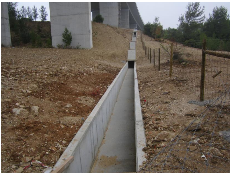
Fig.6. Vista do canal longitudinal de secção retangular
