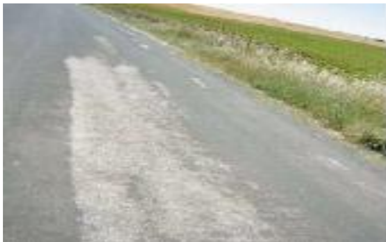
Figura 2. Desprendimento de agregados
