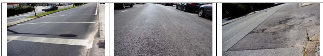
Fig. 2. Aspeto visual do estado dos pavimentos analisados
