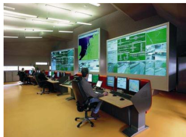
Fig.1. Centro de Controlo
