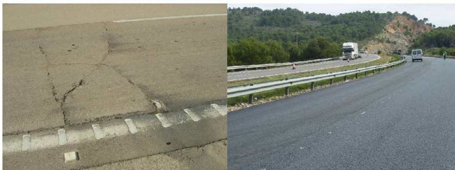
Fig.3 Pavimento fissurado tratado com Betume de Elevadas Prestações
