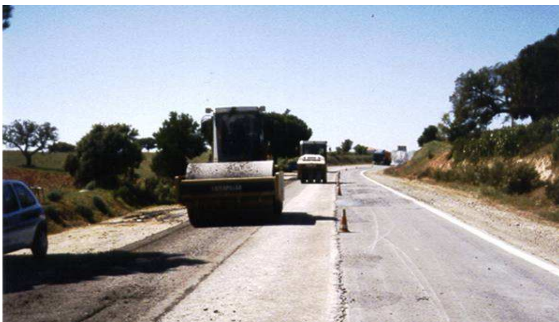
Figura 4 – Equipamento utilizado na compactação de uma camada reciclada in situ a frio
