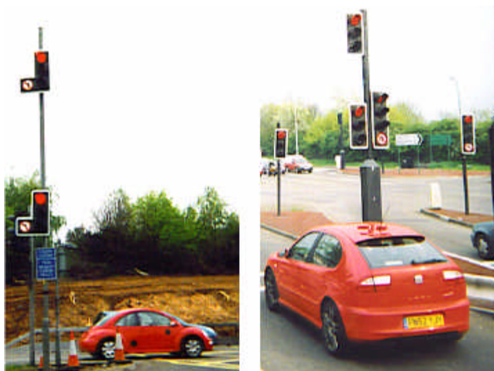
Fig. 11- Semáforos de coluna dupla em área de tráfego intenso de camiões
