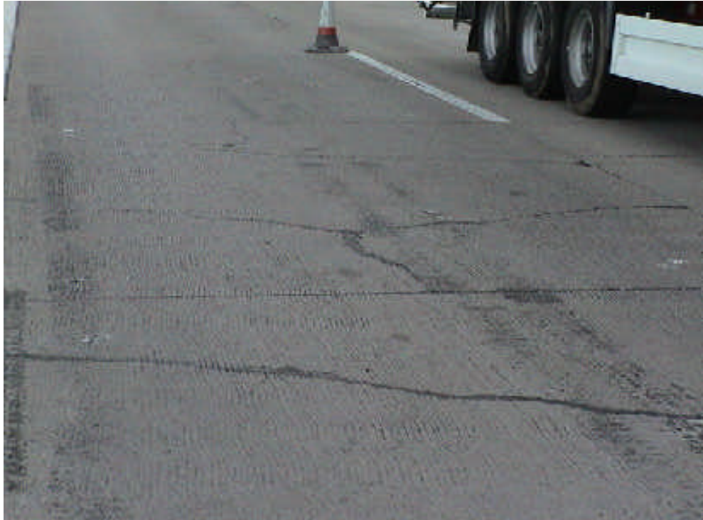
Foto 2. Algunas losas fisuradas. Pavimento rígido en la AP-7.
