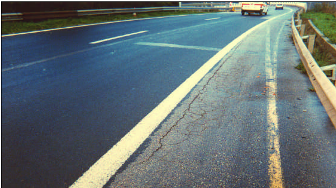
Foto 1 – Estado do pavimento e das bermas antes da intervenção – Ramo 2 das Amoreiras
