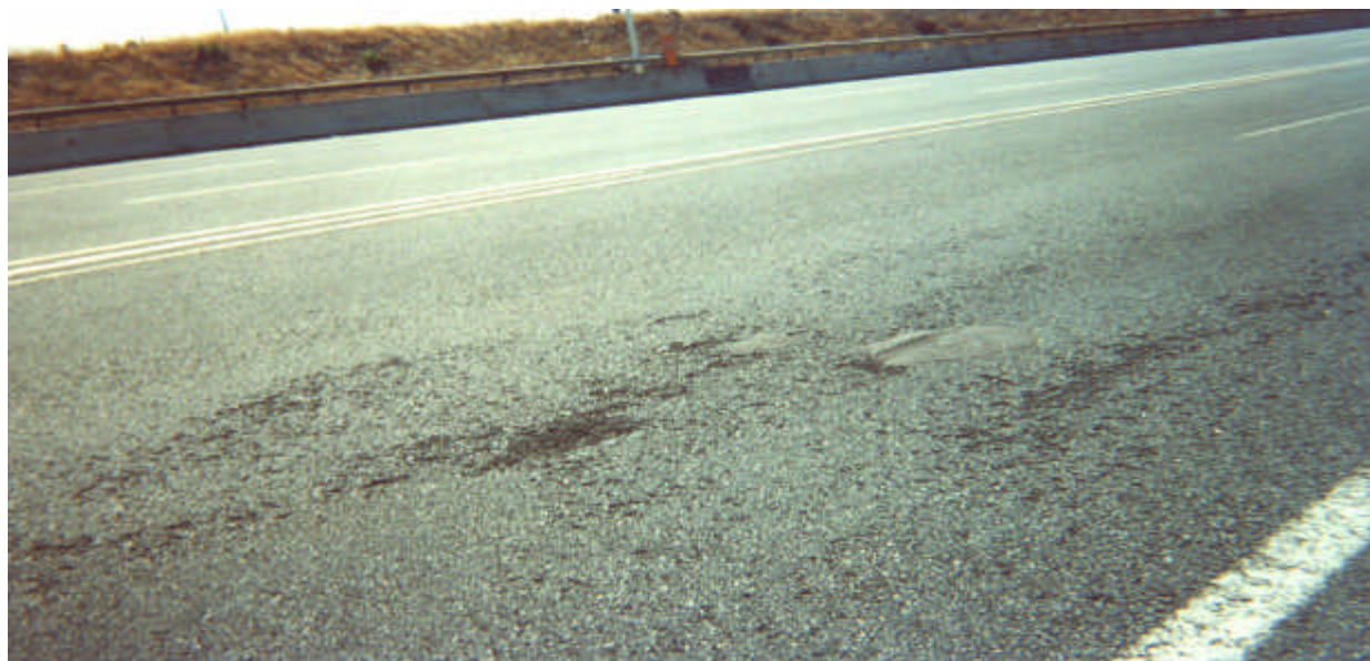
Foto 3 – Estado do pavimento no trecho do Acesso Sul, em 2002
